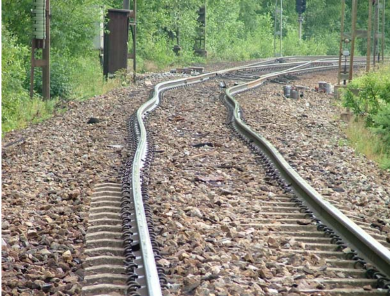
Figur 1. En solkurva är en lokal utknäckning (sidoförskjutning) av ett spår och uppkommer när spåret inte förmår att stå emot stora tryckkrafter som verkar i spårets längdriktning. Solvärme bidrar till att öka tryckkrafterna i spåret.
