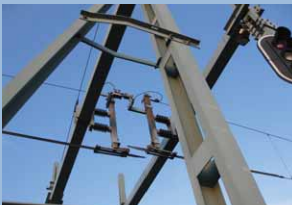
Kontaktledning på befintlig Marieholmsbro.
