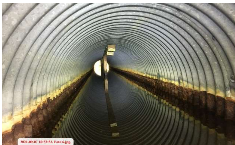
Plåttrumma 1400mm vid Bodtjärnsbäcken (km 21/440). Uppstöttad med träställning och kraftigt rostangripen.
