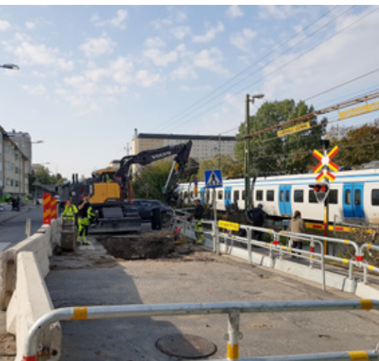
Arbetsplats som saknar SoS-planering och de åtgärder som riskbedömningen (SoS-planering) kommer fram till.
