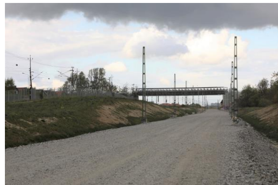
På många ställen längs sträckan har vi redan satt upp stolpar för de tillfälliga spårens kontaktledningar.
