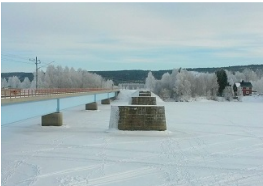
Figur 1. Kvarlämnade gamla brostöd i Vindelälven vid Vännäsby. Befintlig järnväg på balkbro till väster i bild. Foto taget från västra sidan älven.
