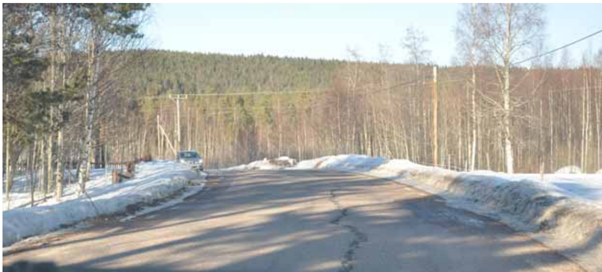
Figur 1.1 Sprickbildning i väg 764, 2011.
