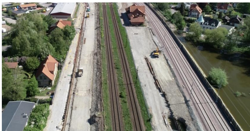
Vid Åkarps station trycker vi ner spont och monterar ankarstag. Bild: NCC/OHL
