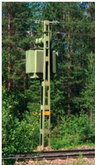
Sugtransformator på kontaktledningsstolpe.
