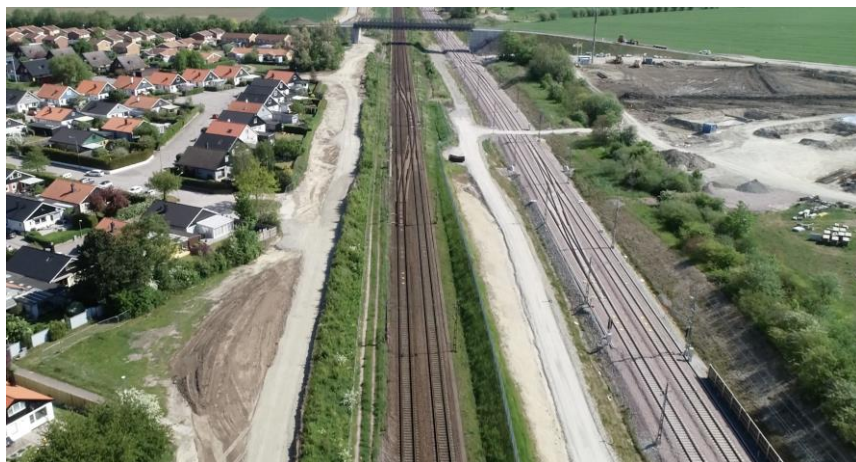
Stödmur med bullerskyddsskärm byggs på den västra sidan om spåren, norr om Åkarps station. Bild: NCC/OHL
